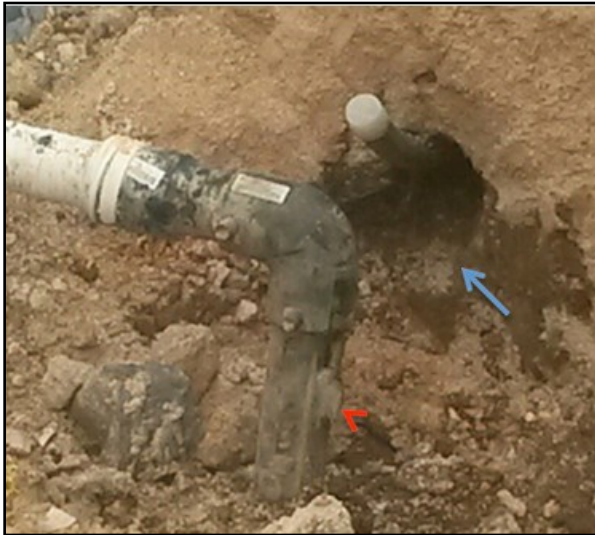
Figura 1 Danneggiamento causa TOT
