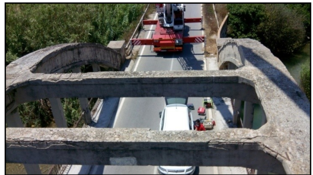
Figura 2 – Monta. Distacco del copriferro
