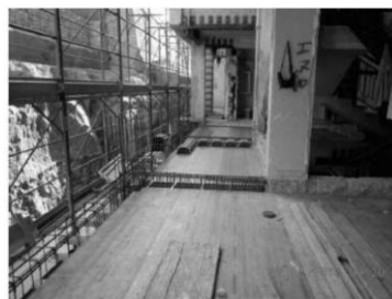
Fig. 14. Ricostruzione elementi crollati
