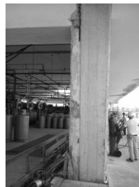
Fig. 3 Degrado pilastro perimetrale
