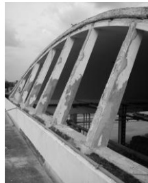
Fig. 2 Degrado dei pilastrini della copertura
