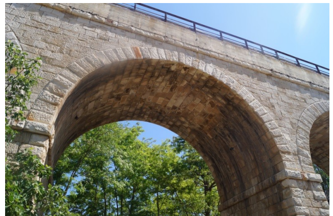
Figura 2. Particolare degrado volta centrale
