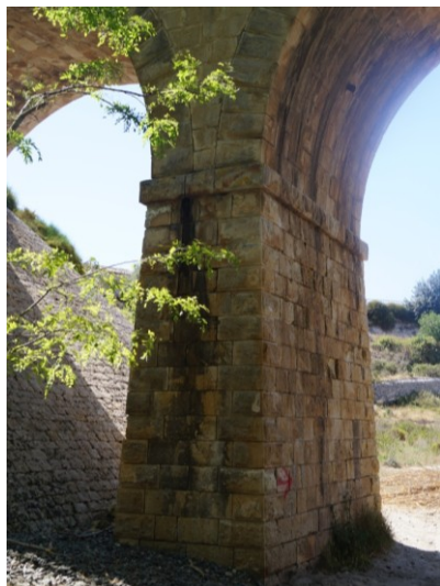
Figura 3. Particolare degrado pila sinistra
