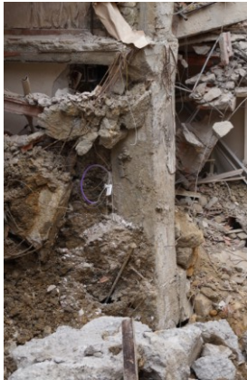
Figura 1. Pilastro e travi collassate
