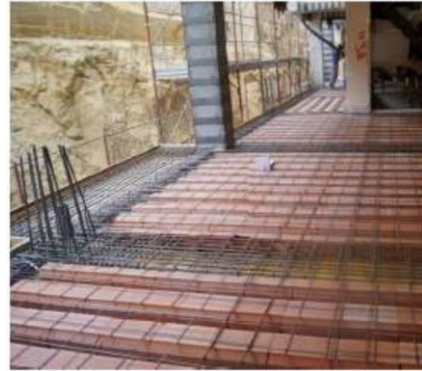
Figura 13 Ricostruzione elementi collassati
