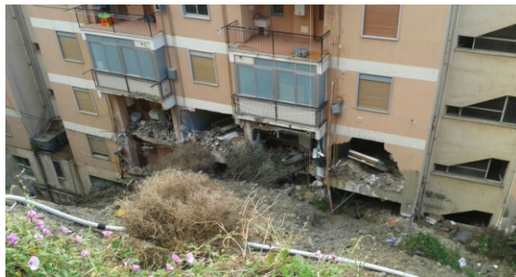
Figura 3. Prospetto Nord dopo la frana
