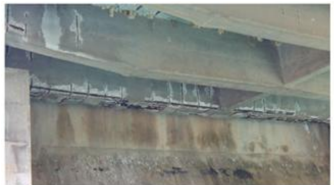
Figure 4. Degradation of cross tested beam with concrete cover spalling and longitudinal and cross bars corrosion /Degrado del traverso di testata con espulsione del copriferro e corrosione delle barre longitudinali e trasversali.
