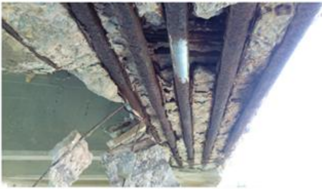
Figure 5. Thrust beam – Concrete cover expulsion, reinforcement corrosion /Trave reggispinta – Espulsione del copriferro, corrosione dell’armatura longitudinale e sfaldamento dell’armatura trasversale
