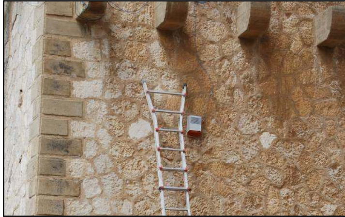
Figura 8: Posizionamento e installazione del dispositivo di allarme
