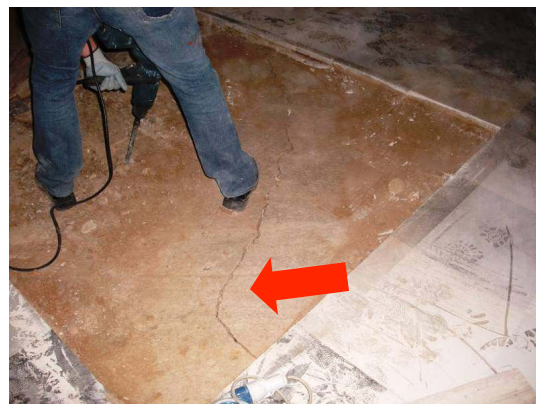
Foto 18: Fessura nascosta dalla pavimentazione
