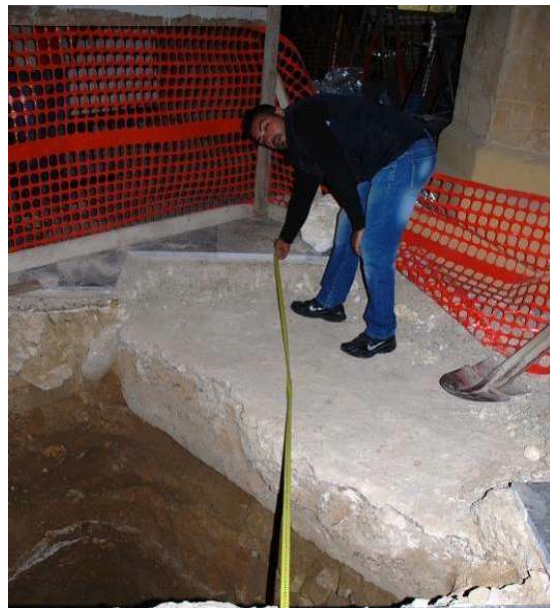
Foto 21: Opere di consolidamento delle fondazioni mediante reticolo di travi in c.a. e micropali
